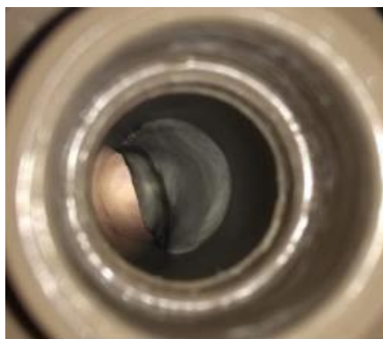
a) Entupimento parcial
